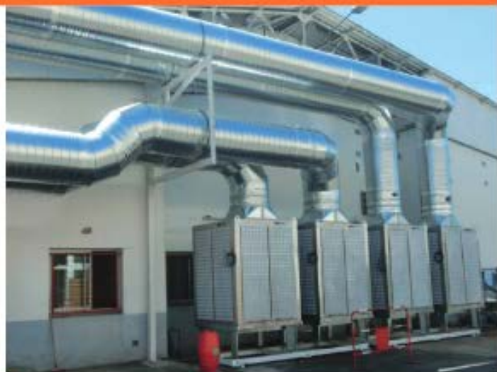
Rafrâchisseurs installés au sol.
