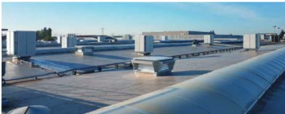
■ Rafraîchisseurs installés en toiture.
