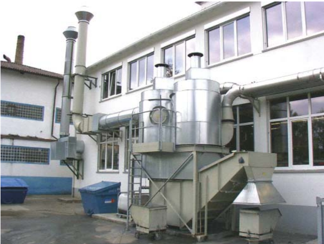
Séparateur VENTURI à voie humide (système ouvert)
