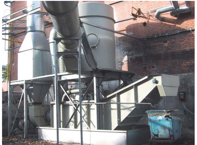
Séparateur VENTURI à voie humide (système ouvert)
