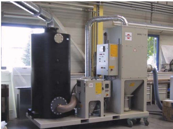
Installation de filtration avec système à charbon actif et installation de dosage pour la gravure laser de rouleaux d'imprimerie
