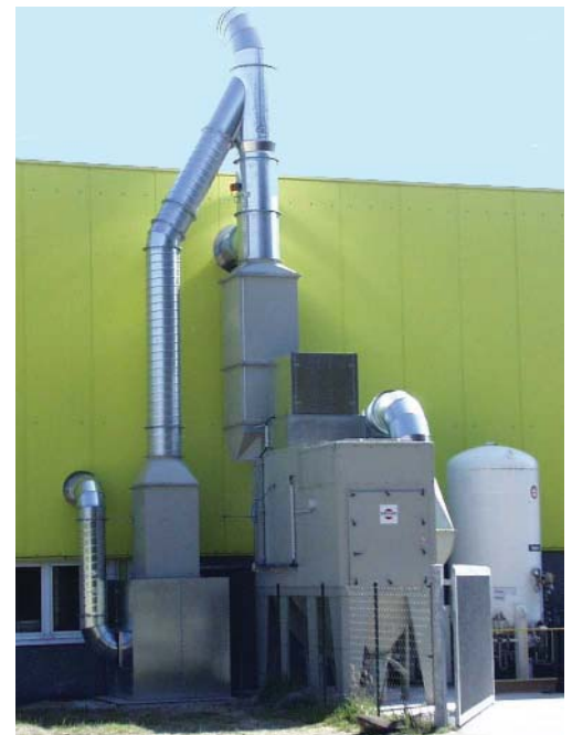
Installation de filtration VARIO
