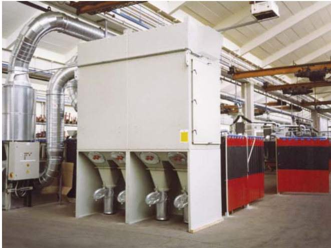
Installation de filtration centralisée...
